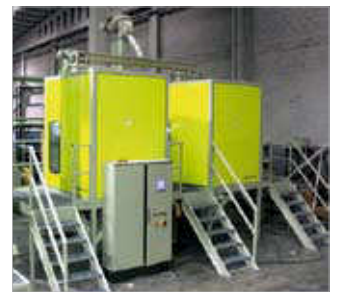
Filteranlage zur Luftreinigung
