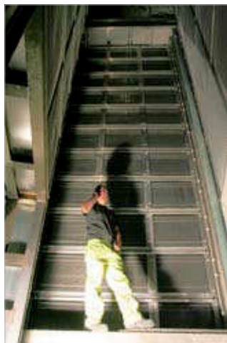
Filteranlage zur Luftreinigung
